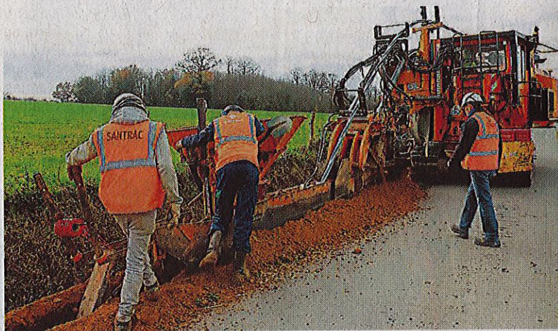
Saint-Michel-et-Chanveaux, hier. Une trancheuse permet en un seul passage de creuser la tranchée, poser le câble, sabler et poser le grillage avertisseur.
